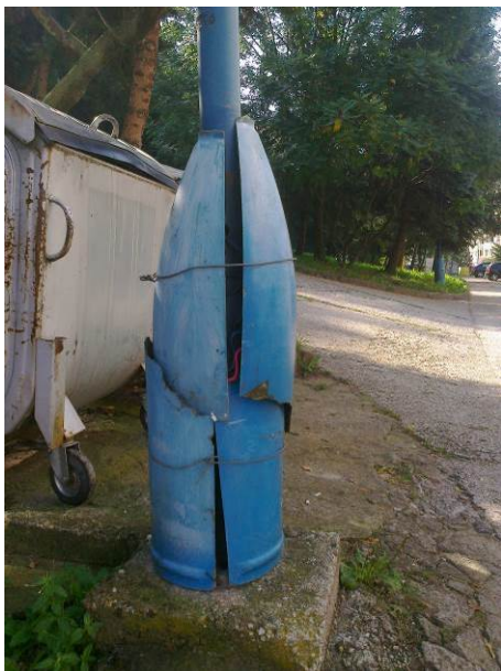
Obr. 5 Poškodená päťka stožiaru
